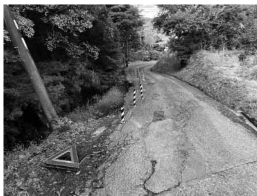
町道高塚線災害現場(筒森地先)
