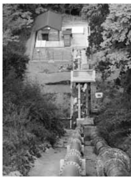
面白峡の小水力発電所
