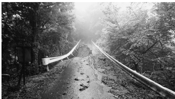
▷大雨によって被害が発生した町道老津線(大田代地先)
