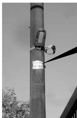
▲LED化された防犯灯
