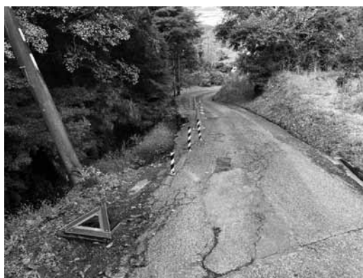
町道高塚線災害現場(筒森地先)
