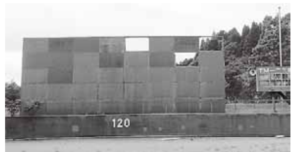
台風21号で被害を受けた野球場バックスクリーン
