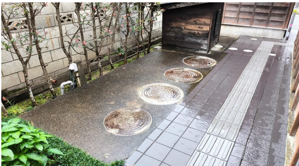
浄化槽（14人槽）・ブローアー
