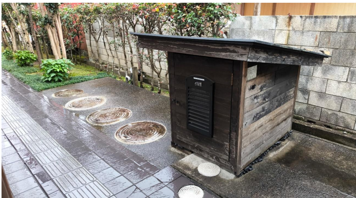
浄化槽（14人槽）・ブローアー
