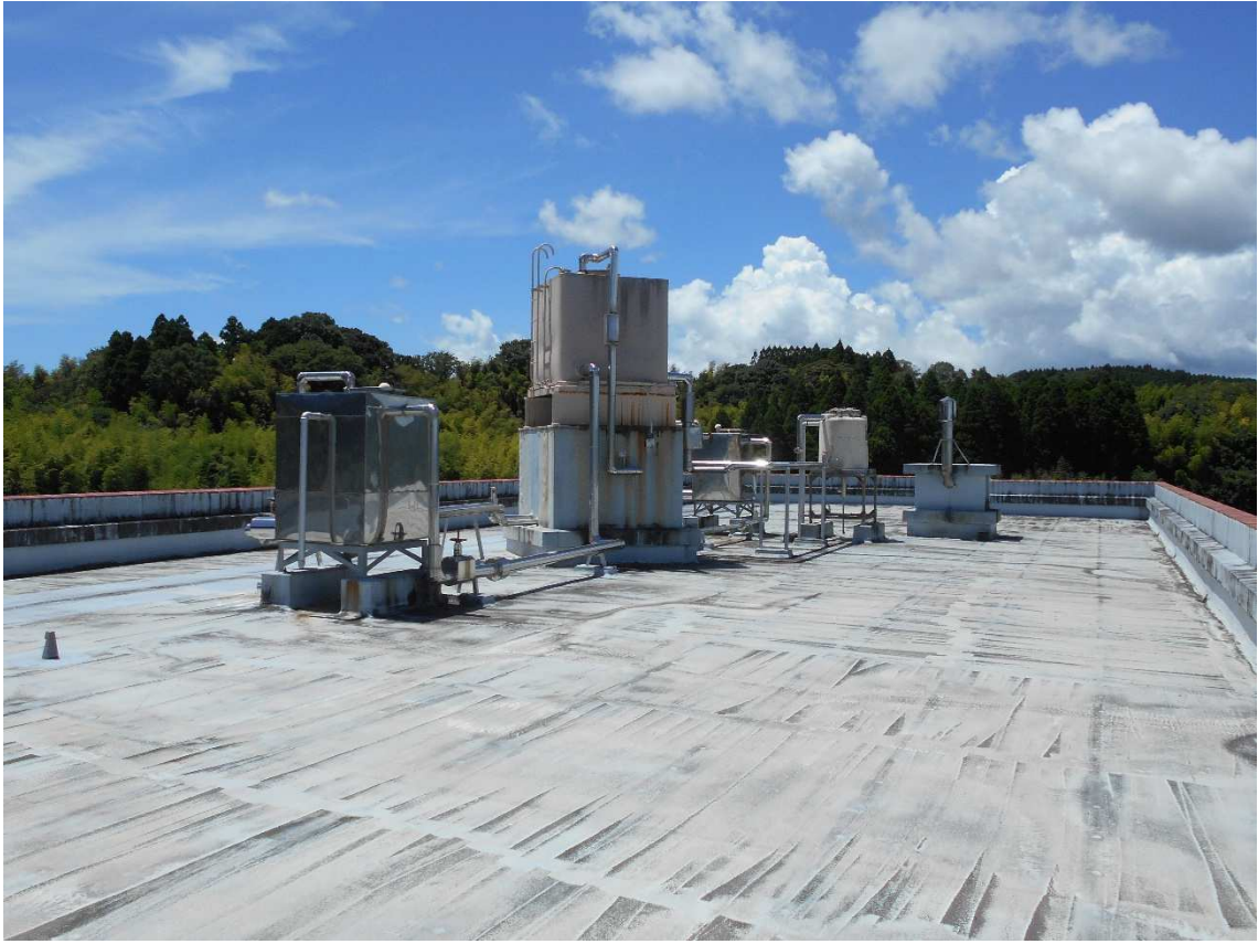
屋上貯水槽等
